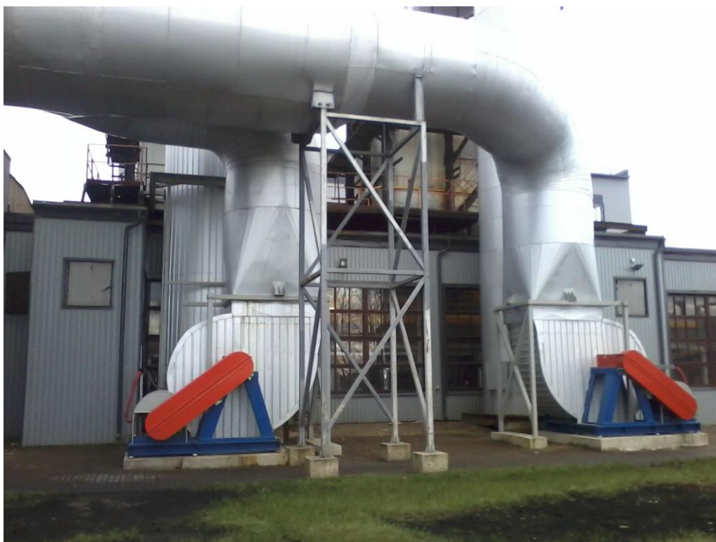
29 pav. Katilinės pastato išorėje eksploatuojami traukos ventiliatoriai
