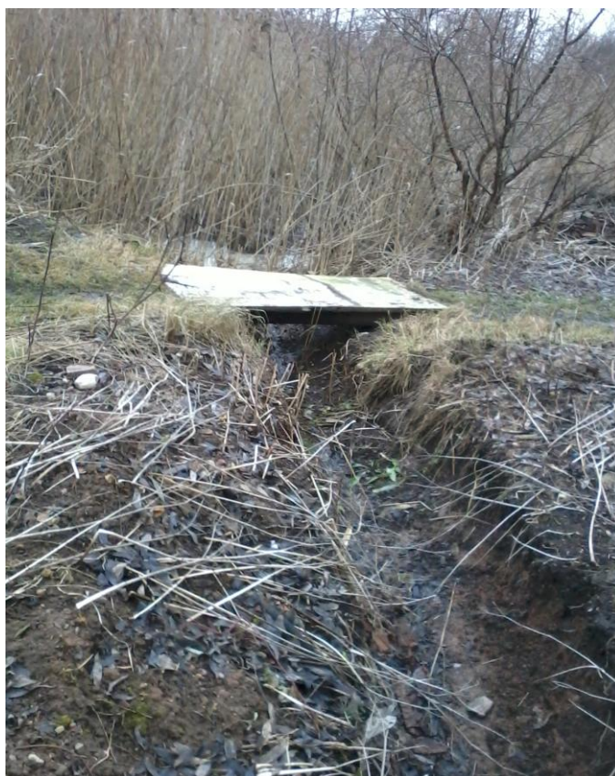
88 pav. Kanalo pylimo perkasa ties Žiogų g. 2016-01-25 d.
