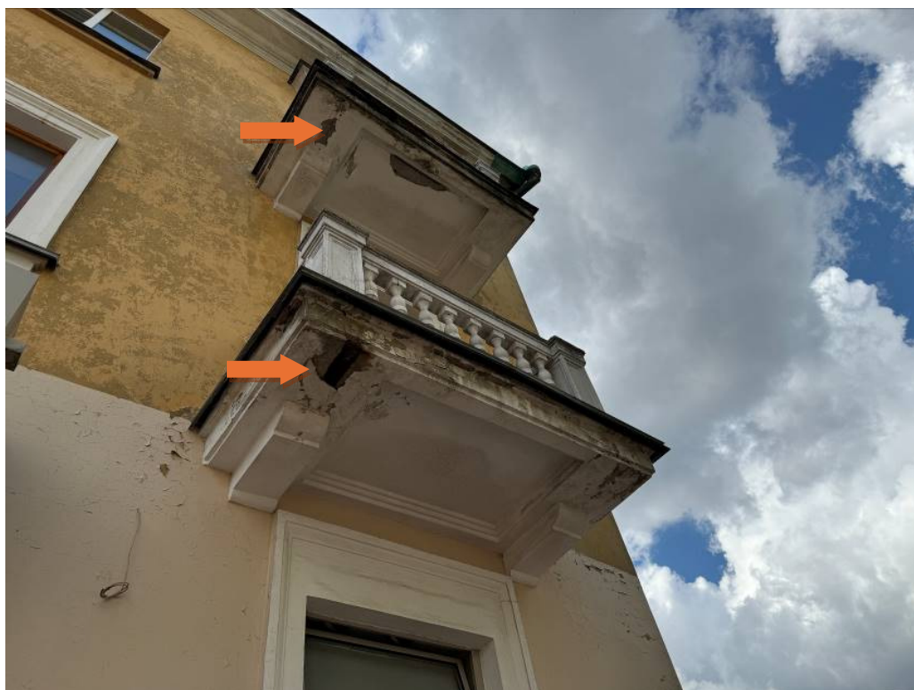
Balkonai. Aprūpėjusios briaunos, konsolės iš apačios, laikančios sijos paveiktos korozijos
