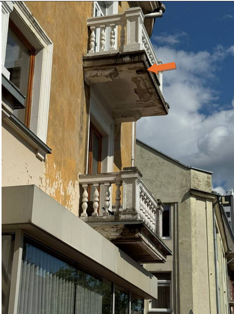
Balkonai. Aprtrupėjusios briaunos, konsolės iš apačios
