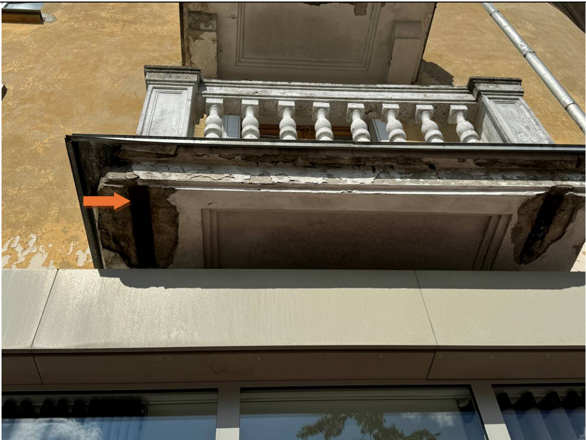
Balkonai. Aptrupėjusios briaunos, konsolės iš apačios, laikiančios sijos paveiktos korozijos
